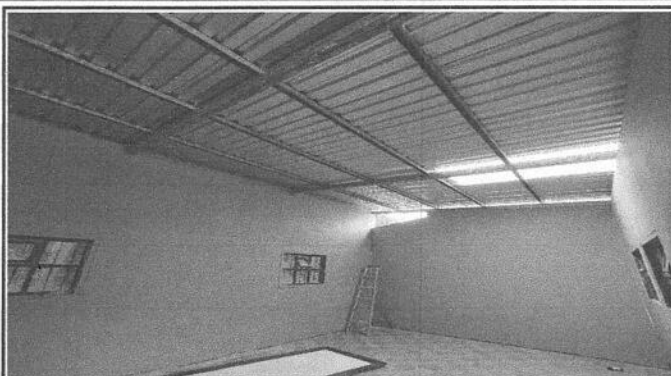
Foto 2: vista interior de modulo de trabajo número 1, con acabados de pared e instalación de techo concluida
